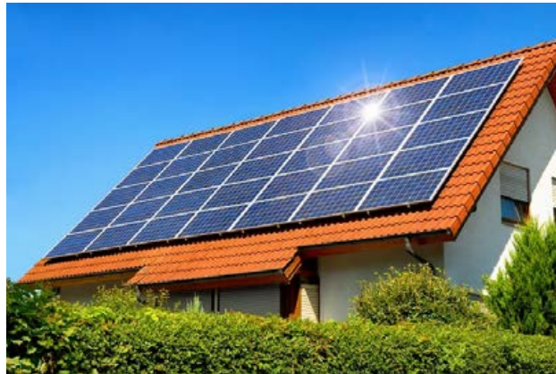
Figura 4 - Usina Solar telhado residência [9]
